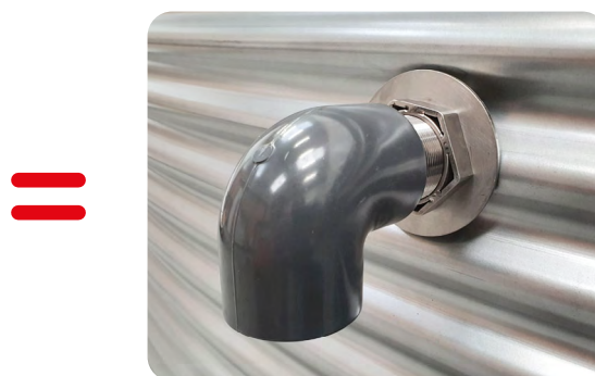
Vue extérieure trop-plein citerne.
